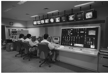
④中央制御室
